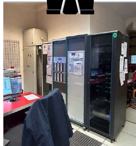
SSI ( système de sécurité incendie)
