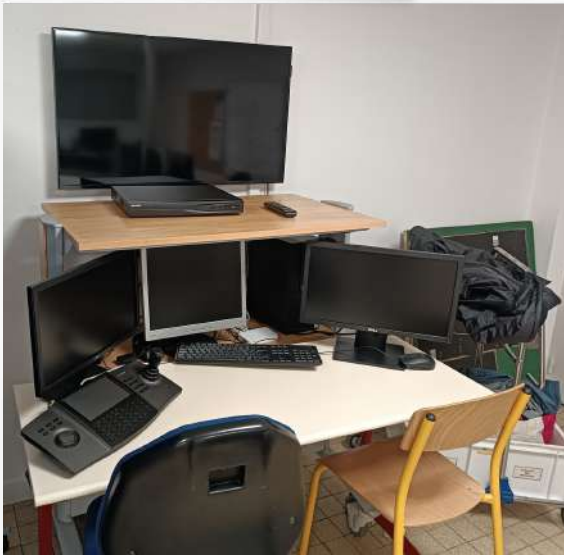
Poste de vidéosurveillance
